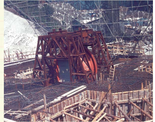
Nach der Tormontage. Mit 30.000 Tonnen Beton und reichlich Stahl in der Bewehrung wurden die Tore im Eingangsbauwerk eingegossen.
