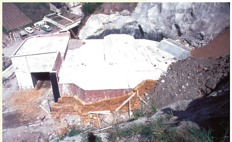
Unter der Haube: Die MAN-Tore sind als Teil des Eingangsbauwerkes in diesem verschwunden (Hauptzugang Dernau).
